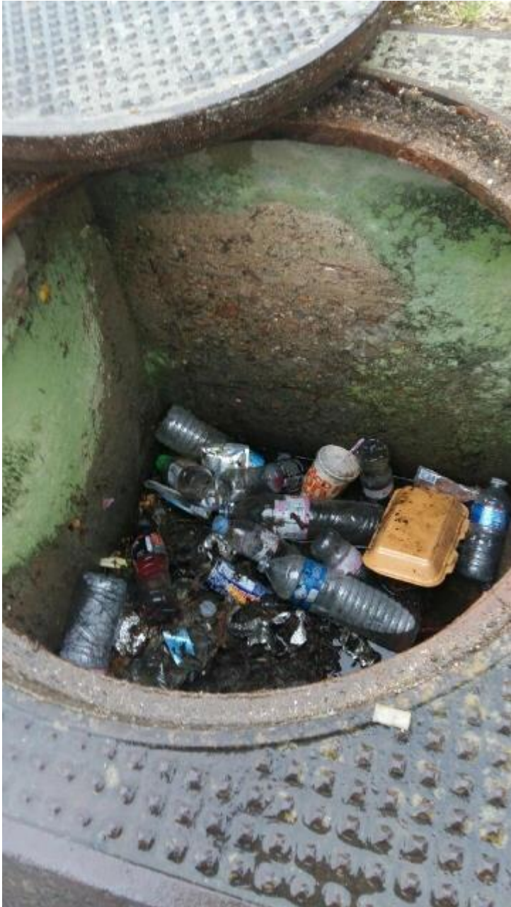
Egout plein de débris
